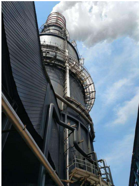
图 3-1 烧结机及其排气筒
