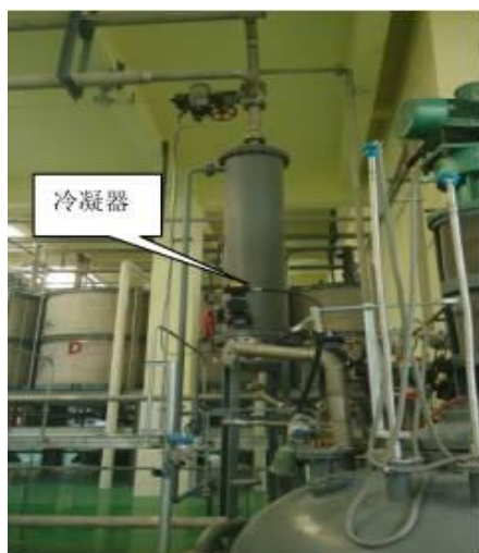
工艺废气冷凝器
