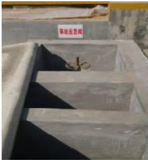
罐区事故应急阀
