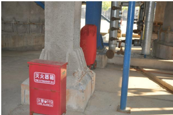
装置区消防器材
