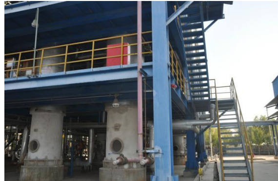
装置区消防设施（消防立管）
