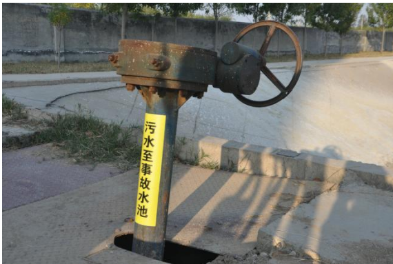
事故废水或初期雨水进事故水池截止阀
