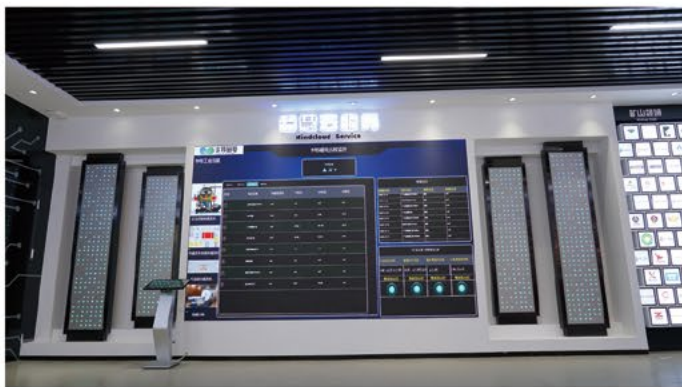
远程中央控制室 Remote Central Control Room
